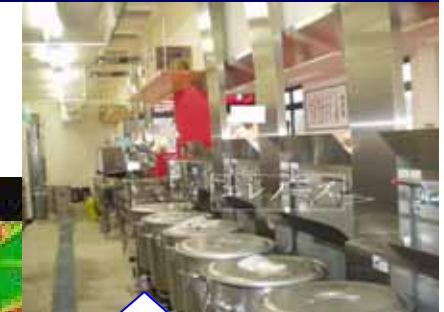
導入モデル「八尾店」 空調機16馬力設置
