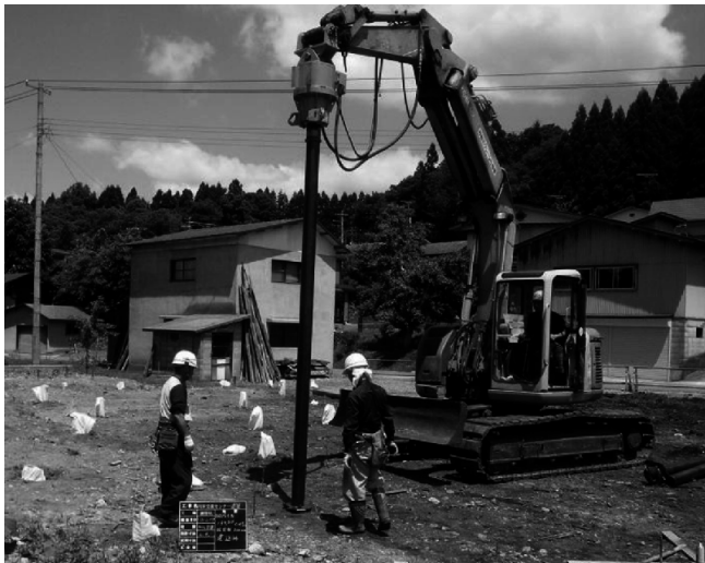
バックホー（油圧ショベル）の先に装着されたbDパイル
