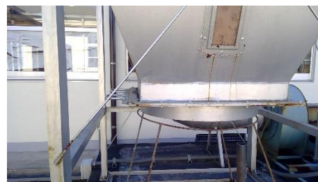
集塵機の蓋部分
